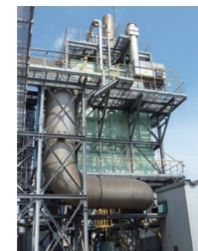
熱風炉の排ガス処理設備
