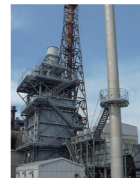
発電所の排ガス処理設備
