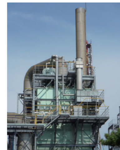
スラグフューミング炉の排ガス処理設備
